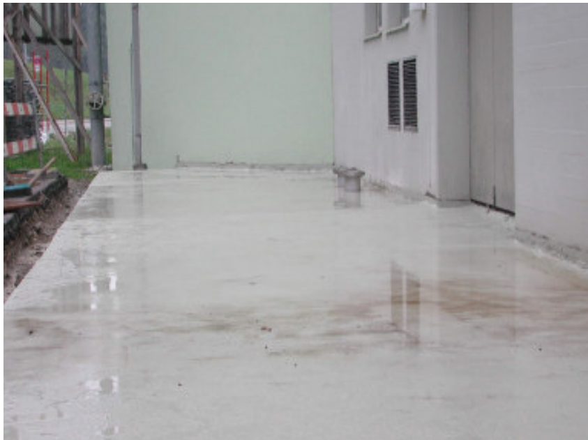
(Rissüberbrückende Abdichtung unter Zementüberzug, ARA Au, St. Gallen)
